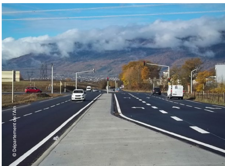
Carrefour CERN à Prévessin-Moëns (RD35): réalisation d'un carrefour à feux en 2017/2018 (Ain).
